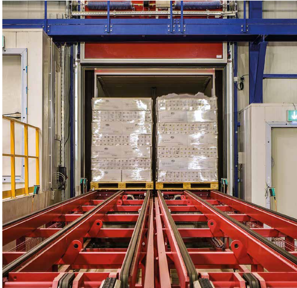
Das automatische Be- und Entladesystem ermöglicht es, einen LKW mit 32 Paletten in nur zwei Minuten vollständig zu entladen.
