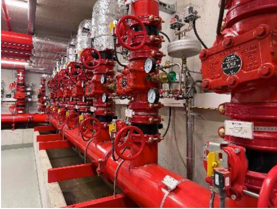
[Sprinklerzentrale Ansicht rechte Seite.jpg]
