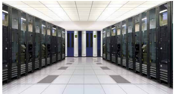
Eine Gaslöschanlage mit Spezial-Löschgas oder eine Brandvermeidungsanlage sorgt im Rechenzentrum für höchste Datensicherheit.
