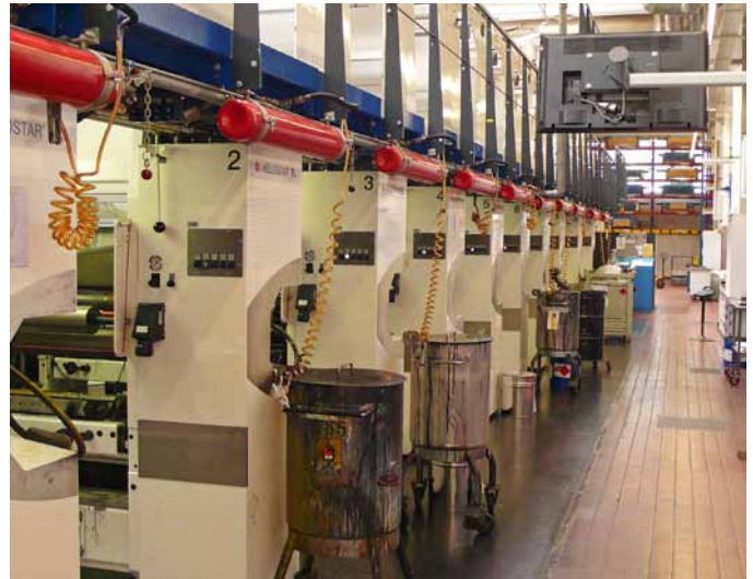
Druckmaschine, geschützt mit einer Speziallöschanlage im 2-Stufen-Konzept. Manuell einzeln auslösbare Druckwerke und automatisch auslösbare Komplettdruckmaschine
